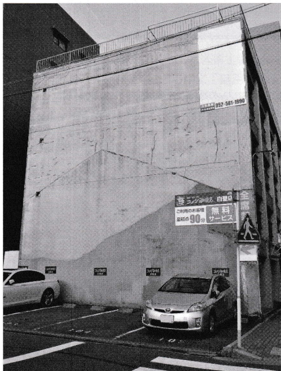
図4／取り壊された隣棟の屋根跡のトマソン
