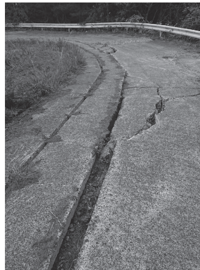
割れ目の入った道路
